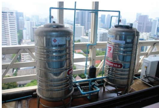
ภาพที่ 2 การต่อเติมและเปลี่ยนแปลงน้ำหนักบรรทุกทุกอาคารด้วยการติดตั้งถังเก็บน้ำบริเวณภายนอกอาคาร ซึ่งอาจมีผลต่อความมั่นคงแข็งแรงของอาคาร
