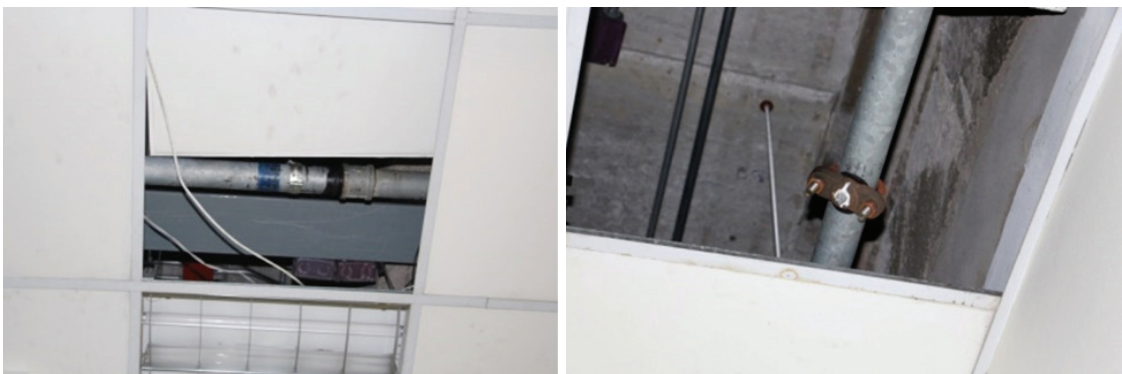
ภาพที่ 7 บริเวณท่อน้ำประปาและท่อระบายน้ำเสียที่มีการปรับปรุงซ่อมแซมแบบชั่วคราวด้วยการนำชุดอุปกรณ์และแผ่นยางมารัดโดยรอบท่อเพื่อแก้ปัญหาการรั่วซึม (ซ้ายและขวา)
