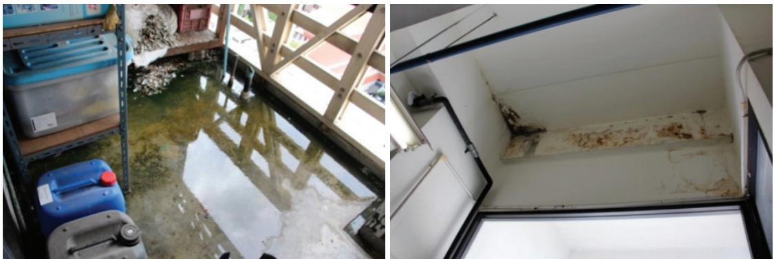
ภาพที่ 9 บริเวณระเบียงภายนอกอาคารบางส่วนมีน้ำท่วมขัง เนื่องจากมีขยะอุดตัน หรือบางส่วนมีการปรับระดับความลาดชันของพื้นให้น้ำไหลไปยังฝาท่อระบายน้ำฝนไม่เหมาะสม ทำให้ไม่สามารถระบายน้ำได้อย่างมีประสิทธิภาพ (ซ้าย) และเกิดคราบสนิมจากเหล็กภายในโครงสร้างของบริเวณพื้นและคานอันเนื่องมาจากการรั่วซึมและน้ำขังบริเวณระเบียงภายนอกอาคารด้านบน ซึ่งอาจส่งผลต่อความมั่นคงแข็งแรงของอาคาร หากยังคงปล่อยทิ้งไว้ในสภาพดังกล่าวต่อไป (ขวา)
