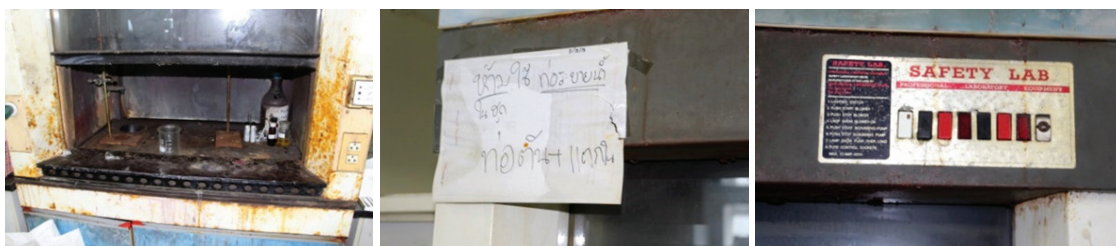
ภาพที่ 13 ตู้ดูดควันที่มีสภาพชำรุดและกักความร้อน (ซ้าย) ระบบท่อน้ำภายในตู้เสียหาย (กลาง) และระบบการป้องกันและเตือนด้านความปลอดภัยไม่สามารถทำงาน (ขวา)
