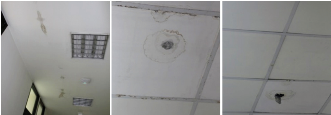
ภาพที่ 6 คราบน้ำที่รั่วซึมบริเวณฝ้าเพดานแบบฉาบเรียบ (ซ้าย) และแบบทีบาร์ (T-bar) (กลางและขวา) ซึ่งปรากฏอยู่ตามบริเวณทางเดินภายนอกและบริเวณพื้นที่ทำงานภายในห้องปฏิบัติการ บางส่วนพบว่าแผ่นยิบซัมบอร์ดเกิดการฉีกขาดและทะลุลงมา (ขวา) จากน้ำและความชื้นที่รั่วไหลจากท่อน้ำประปาและท่อระบายน้ำเสียที่อยู่เหนือระดับฝ้าเพดาน
