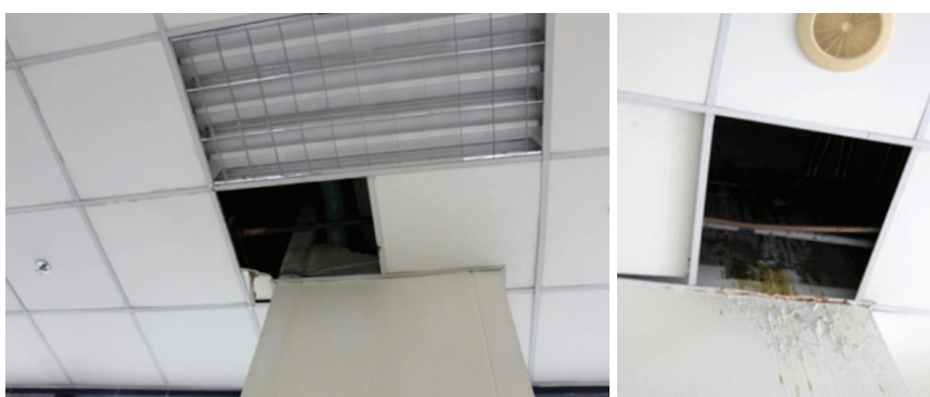
ภาพที่ 4 สภาพภายในห้องปฏิบัติการ (ซ้าย) และบริเวณทางเดินภายในอาคาร (ขวา) ซึ่งมีการรั่วซึมของน้ำจากท่อน้ำประปาและท่อระบายน้ำเสียที่บริเวณเหนือฝ้าเพดานลงมายังบริเวณด้านล่าง มีการเปิดฝ้าเพดานบางส่วนไว้ และยังไม่ได้มีการดำเนินการแก้ไขการรั่วซึมและฝ้าเพดานให้กลับมามีอยู่ในสภาพที่ใช้งานได้ดีตามปกติ
