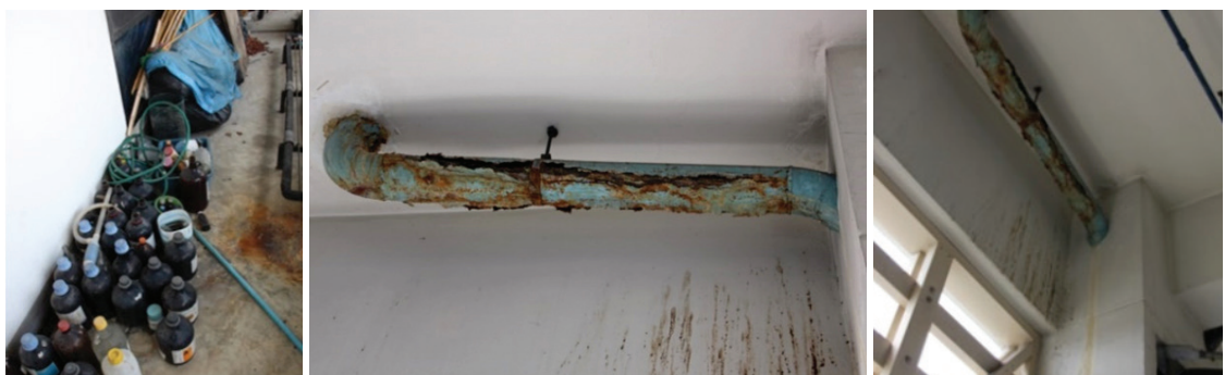
ภาพที่ 10 การนำสารเคมี ขยะ และของเสียมาดังอยู่บริเวณระเบียงภายนอกอาคาร (ซ้าย) ในหลายพื้นที่ของอาคาร โดยไม่มีภาชนะรอง (secondary container) ซึ่งเป็นสาเหตุหนึ่งที่ทำให้เกิดการกัดกร่อนของท่อระบายน้ำฝนที่เป็นท่อเหล็ก (กลางและขวา)
