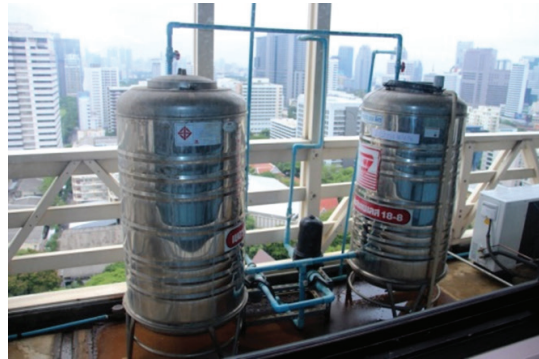
ภาพที่ 2 การต่อเติมและเปลี่ยนแปลงน้ำหนักบรรทุกอาคารด้วยการติดตั้งถังเก็บน้ำบริเวณภายนอกอาคาร ซึ่งอาจมีผลต่อความมั่นคงแข็งแรงของอาคาร
