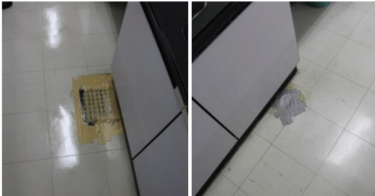
ภาพที่ 8 บริเวณฝาท่อระบายน้ำบนพื้นภายในห้องปฏิบัติการที่มีกลิ่นของสารเคมีจากท่อระบายน้ำเสียดันกลับเข้ามาภายในห้องปฏิบัติการที่อยู่ระดับชั้นตรงกลางของอาคารใต้ห้องปฏิบัติการที่มีการใช้สารเคมี มีการแก้ปัญหาชั่วคราวด้วยการนำแผ่นกระเบื้องยางและเทปกาว (ซ้าย) หรือ เทปกาว (ขวา) มาปิดทับเพื่อมิให้เกิดการย้อนของกลิ่น
