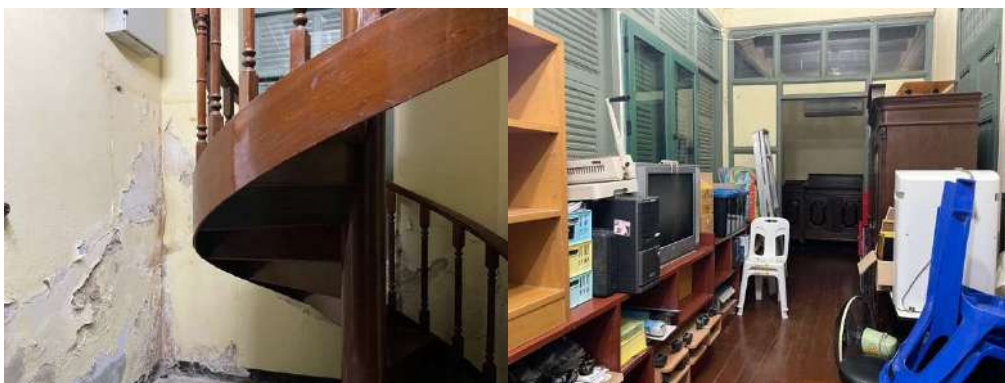
ภาพที่ 9 สภาพความเสียหายจากความชื้น และการใช้งานเป็นห้องเก็บของเหลือใช้สำนักงาน ที่มา: ชนะภพ วัฒนโอฬาร
