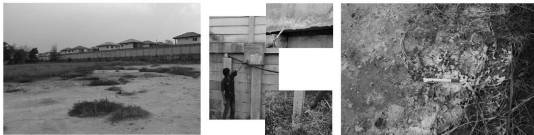
รูปที่ 5 รูปแสดงพื้นที่ดินเค็ม >50% ตามเส้นทางถนนมลิวัลย์ระหว่างบ้านเปิด-บ้านท่ม คราบเกลือบนผนังกำแพงคอนกรีตและการเสื่อมสภาพของเสาคอนกรีตเนื่องจากดินเค็ม
