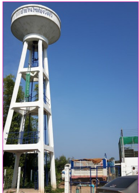
ภาพที่ 1 ระบบประปาบาดาลชุมชน
