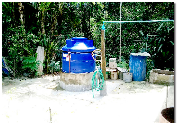
ภาพที่ 6 บ่อหมักแก๊สชีวภาพแบบถังลอยที่ติดตั้งในชุมชน
