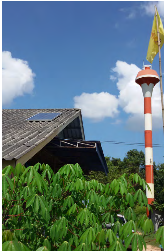
ภาพที่ 3 โซล่าเซลล์ที่ติดตั้งในระบบประปาหมู่บ้านรวมพลัง ตำบลคำขวาง อำเภอวารินชำราบ ทำให้ค่าไฟฟ้าลดลง
