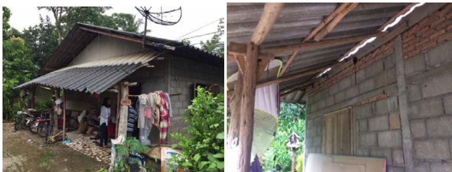
ภาพ 3 แสดงมุมมองด้านหน้าบ้าน (ซ้าย) และร่องรอยฉาบปิดรอยผนังร้าว (ขวา)
