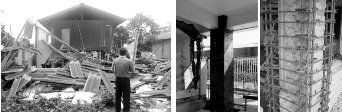
ภาพที่ 19 ความเสียหายที่เกิดกับสิ่งปลูกสร้าง และการเสริมความแข็งแรงให้กับโครงสร้างเดิม (ทยากร, 2557)
